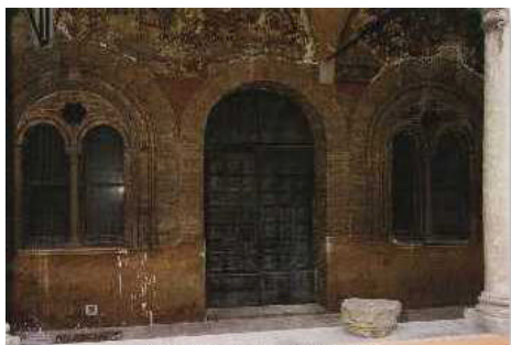
Sala capitolare di S. Agostino (Fano) Ingresso e bifore prima dell'intervento di restauro finanziato dalla Fondazione
